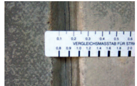
Bild 9: Riss in der Arbeitsfuge
