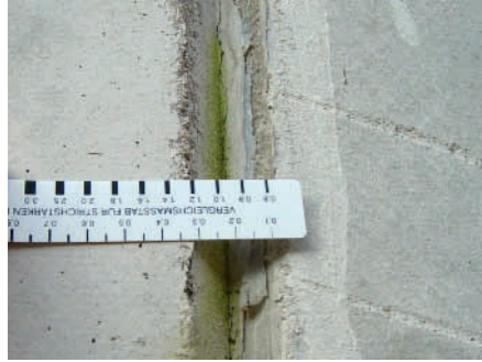
Bild 11: Rissbild an der Schadensstelle nach vorübergehender Trocknung
