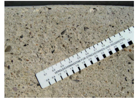
Bild 8: Trennriss im Wandkopf einer Längswand
