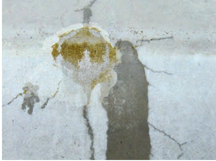
Bild 10: Feuchtigkeitsdurchtritt an einer ursprünglichen Spannstelle der Schalung
